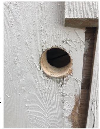
2+ inch hole for conduit
